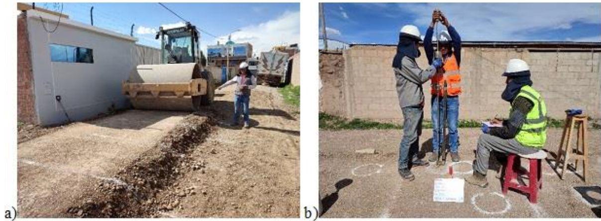
Figura 7. a) Compactación del relleno de pruebas con rodillo, b) prueba de DCP. Fuente: los autores
