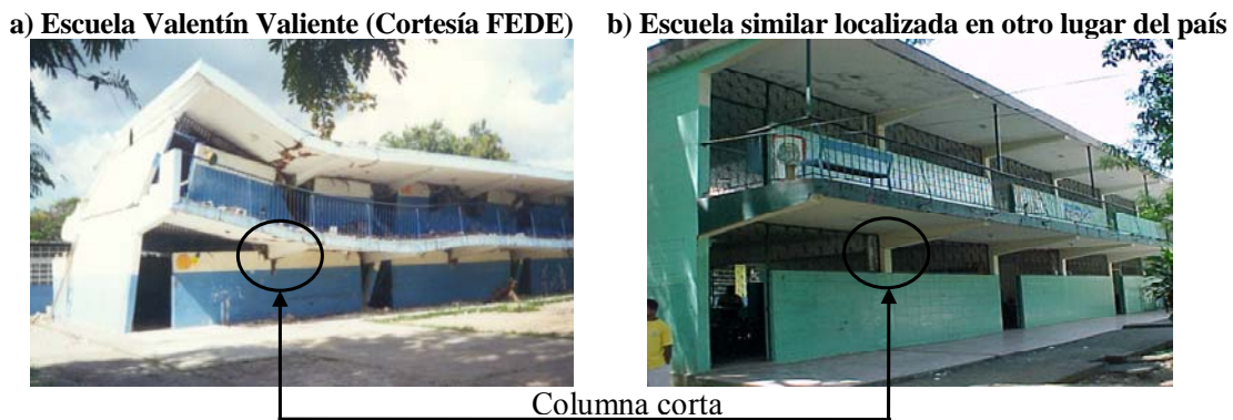
Figura 2.5. Los dos edificios de la escuela Valentín Valiente derrumbados en el sismo de Cariaco de 1.997 son del Tipo Antiguo I que se encuentra en muchos otros lugares del país.
