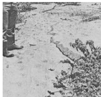
Figura 2. Grieta en márgenes del río Tocuyo, estado Lara. Fuente: Arcia et al. , (1975).
