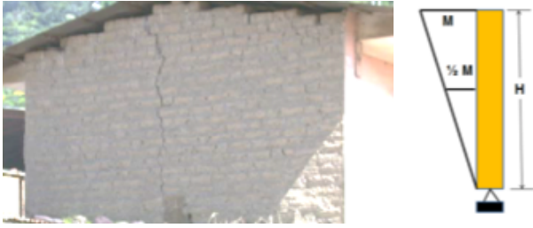
Figura 6. Propagación de la falla por flexión en el centro del muro y variación del momento flector “M” en la altura
