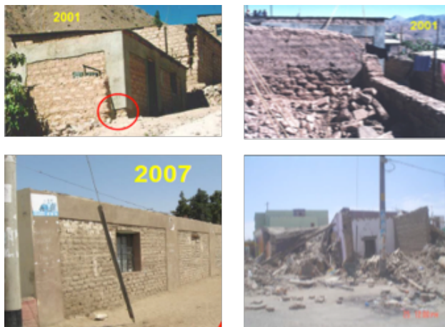
Figura 24. Comportamiento de las viviendas reforzadas con la malla y sin reforzar ante los terremotos del 2001 y 2007 en Perú
