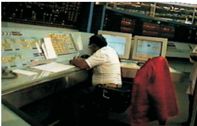
Figura N°1. Puesto Central de Control (PCC): mesa y tableros ópticos
